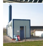
Transportabel 7 Varmecentral Teknikvej 26 5260 Odense S
