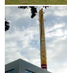
Vollsmose Varmecentral Kildegårdsvej 45 5240 Odense NØ
