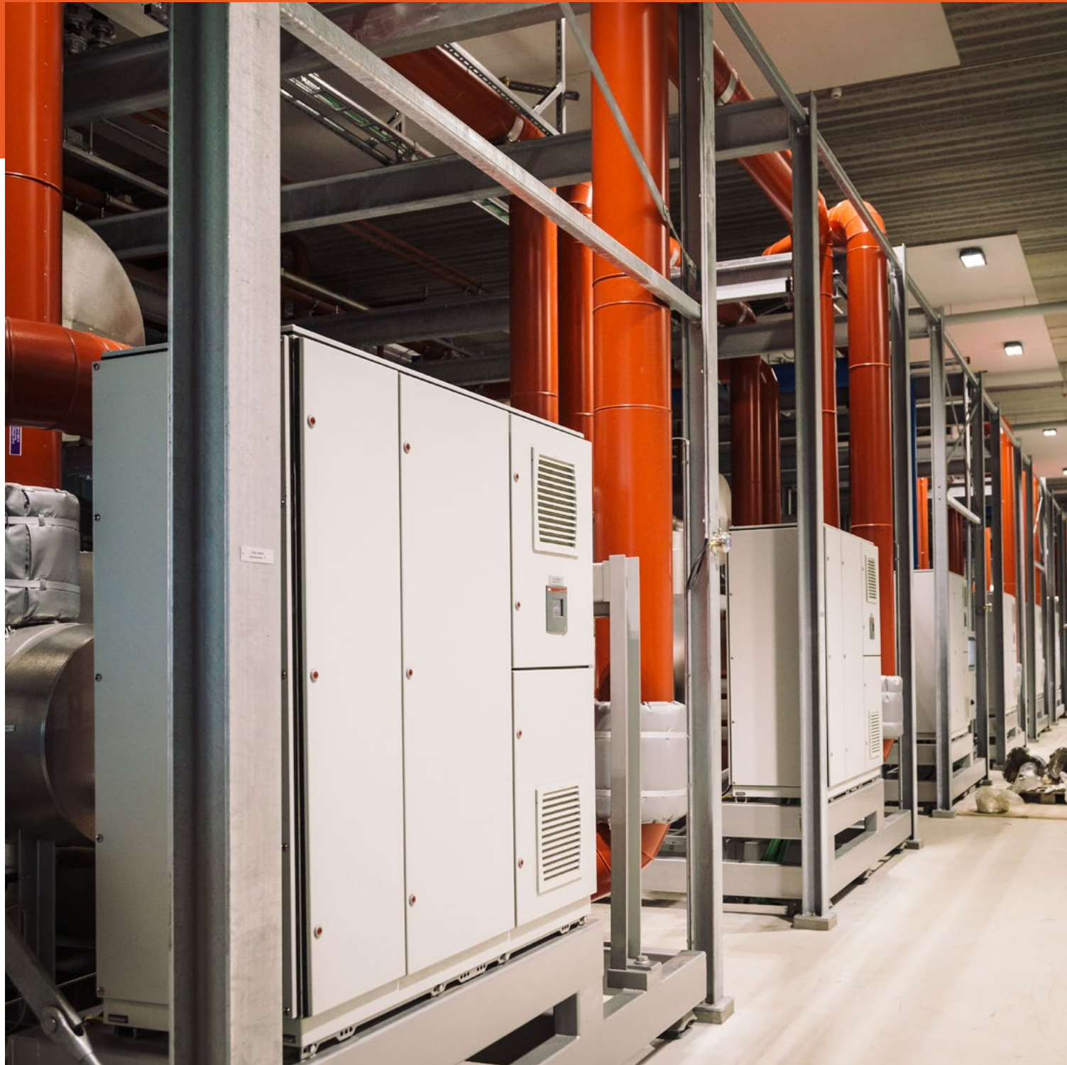
De store varmepumper på Tietgenbyens Varmecentral sørger for at udnytte overskudsvarme fra Facebooks datacenter til fjernvarme.
