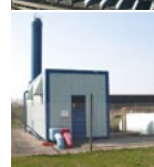
Transportabel 7 Varmecentral Teknikvej 26 5260 Odense S
