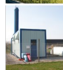
Transportabel 7 Varmecentral Teknikvej 26 5260 Odense S
